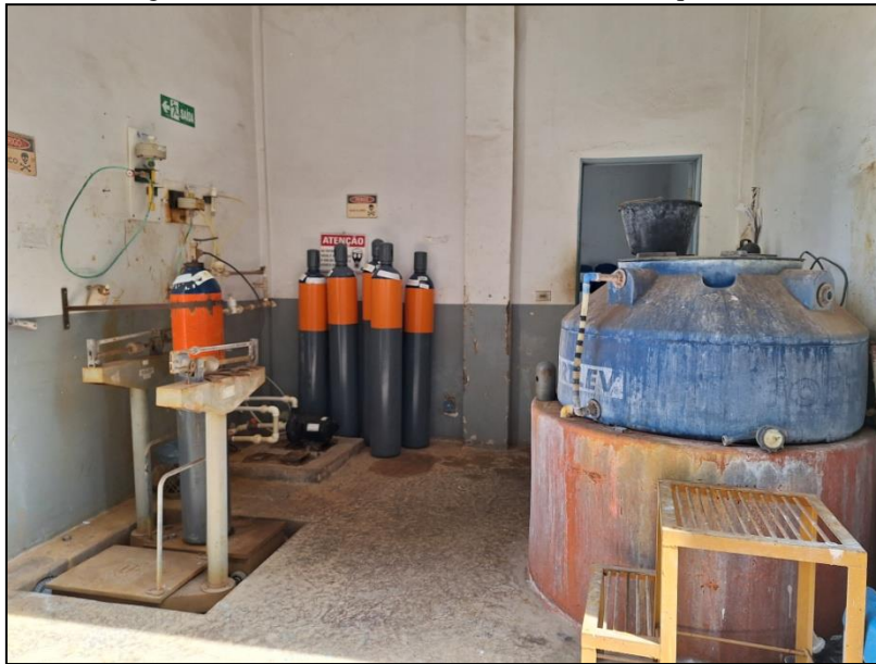
Figura 22: Caixa de flúor e cilindros de cloro liquefeito
