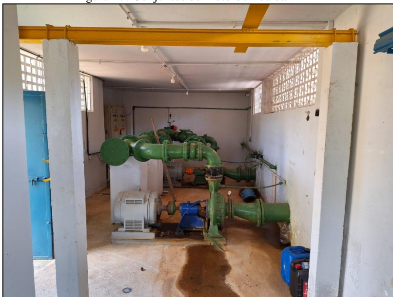
Figura 17: Conjuntos de moto-bomba da EEAB
