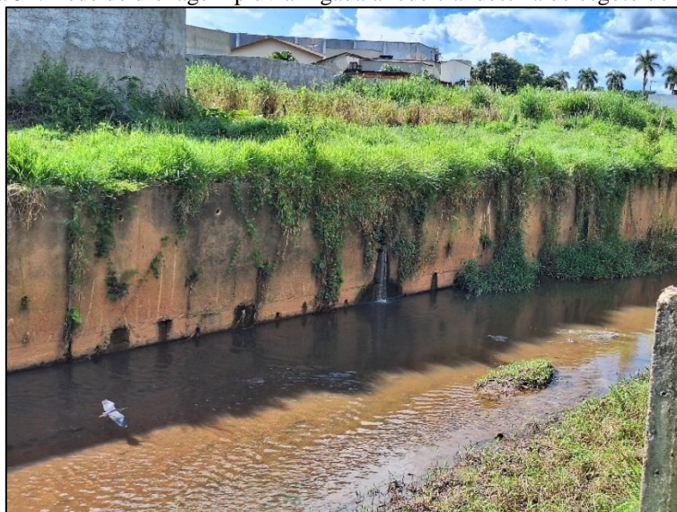
Figura 54: Rede de drenagem pluvial ligada a rede clandestina de esgoto doméstico
