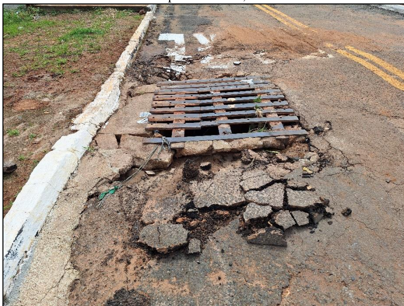
Figura 69: Boca de lobo danificada por enxurrada, localizada na Rua João P. da Silva
