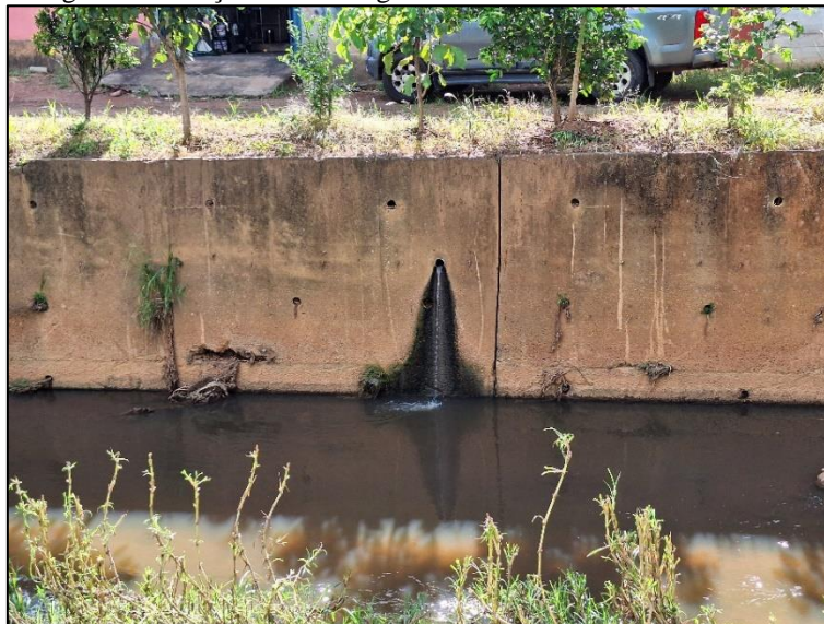
Figura 53: Lançamento de esgoto in natura no Ribeirão Vai Vem
