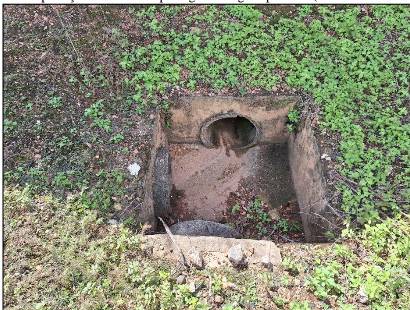
Figura 60: Falta de proteção em caixa de passagem de águas pluviais (Rua Maria José Faria, Centro)
