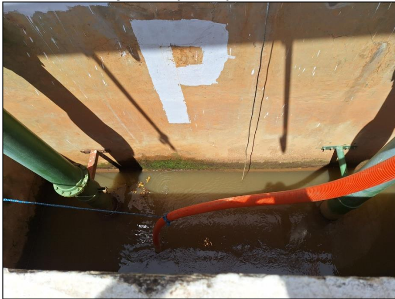
Figura 16: Poço de sucção da EEAB
