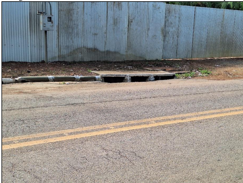
Figura 64: Boca de lobo construída na Avenida Francisco Vaz Lopes
