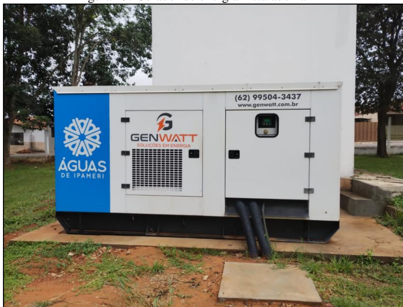
Figura 25: Gerador de energia instalado na ETA
