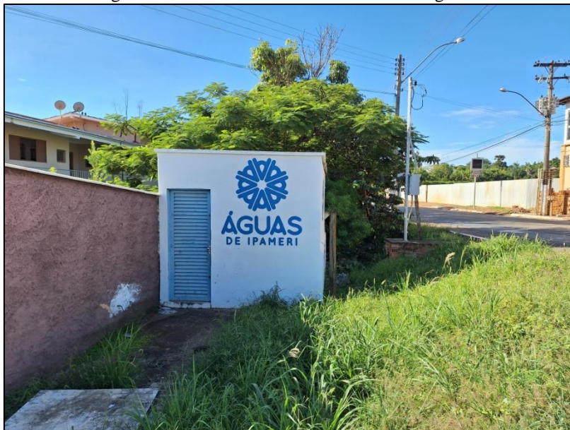
Figura 42: Booster localizado no bairro Village Sul
