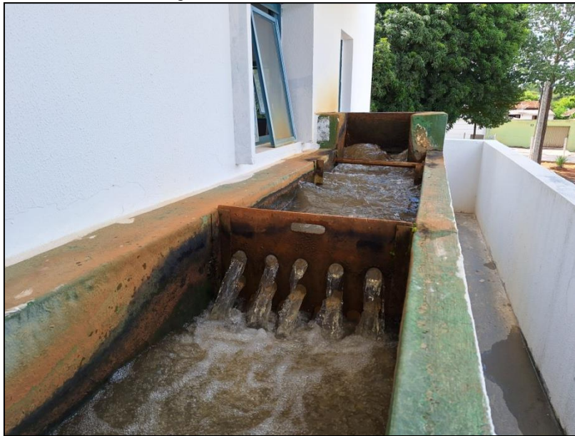
Figura 26: Grades e calha Parshall
