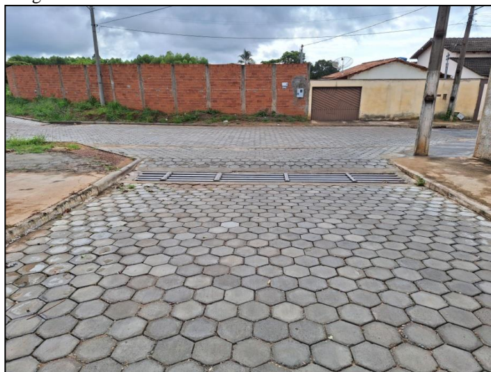
Figura 62: Boca de lobo linear metálico instalado na Rua SR-5
