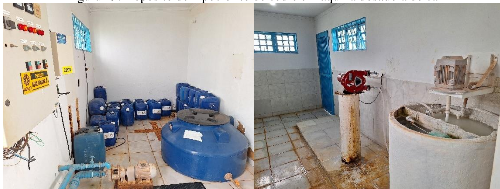
Figura 49: Depósito de hipoclorito de sódio e máquina dosadora de cal
