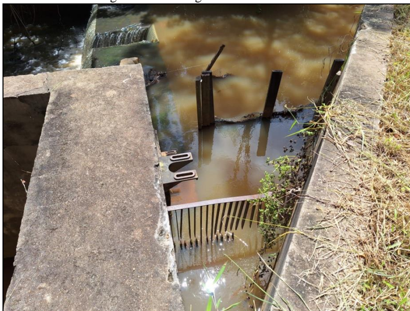
Figura 13: Grade grossa e caixa de areia
