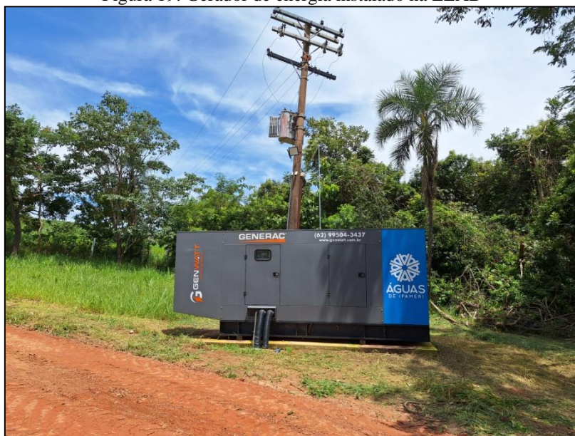
Figura 19: Gerador de energia instalado na EEAB
