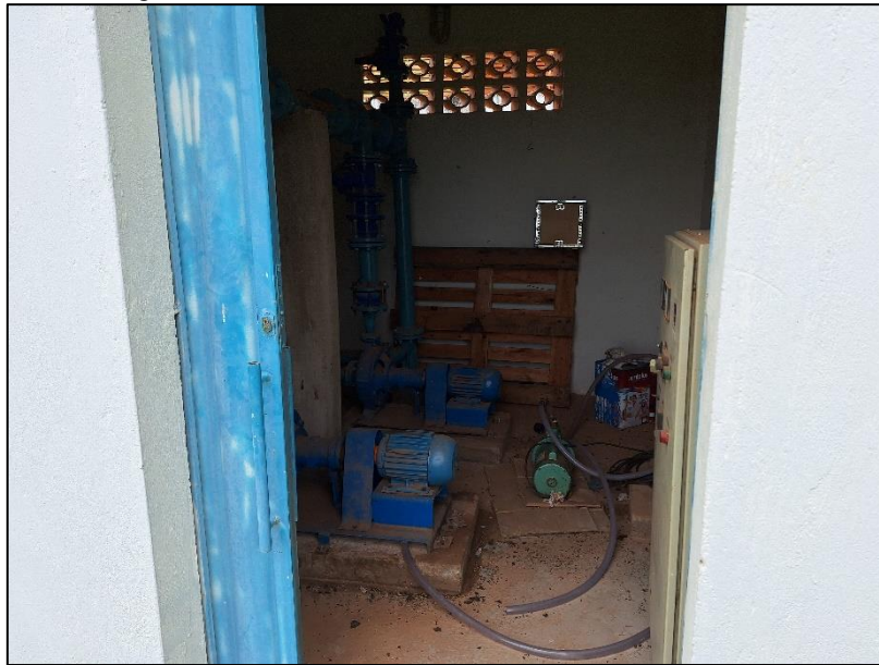
Figura 48: Casa de bombas do RAP 100 m 3 e REL 30 m 3
