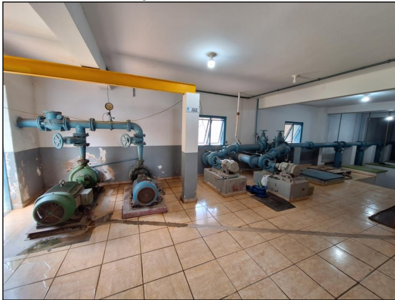
Figura 24: Sala de bombas
