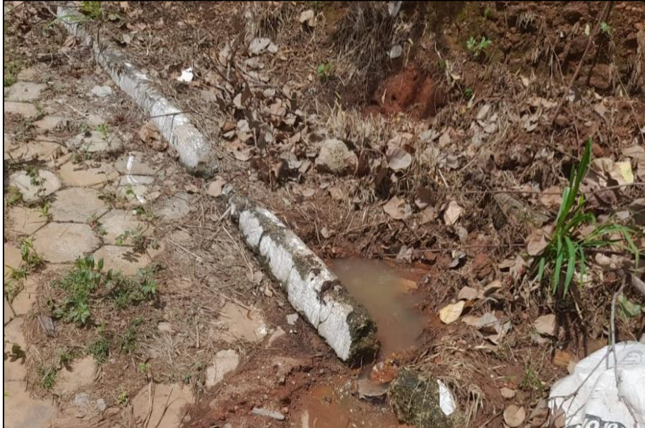
Figura 55: Rompimento de tubulação clandestina de esgoto na Rua Intendente J. Vaz
