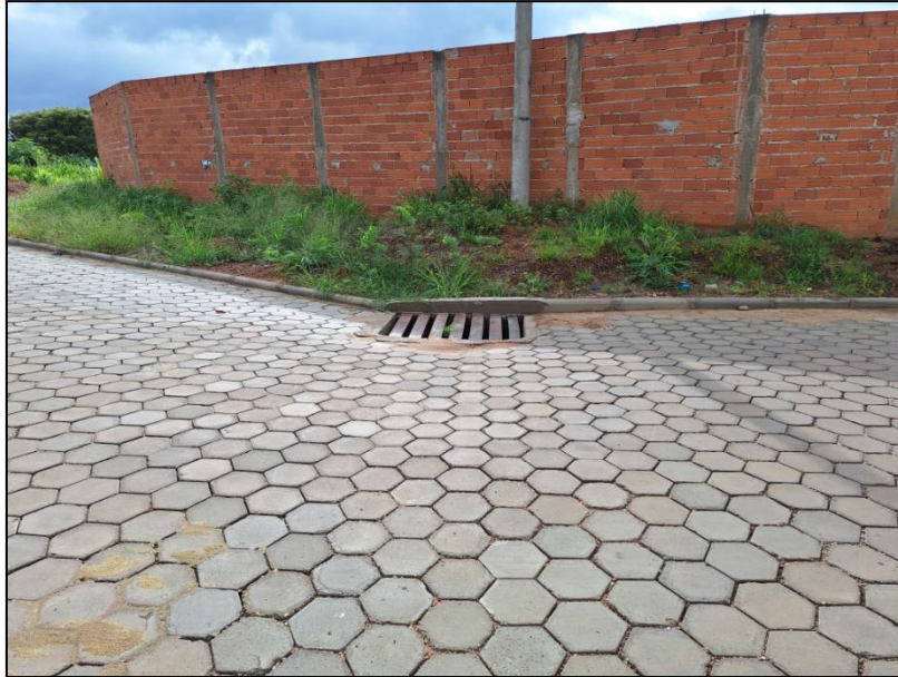
Figura 63: Boca de lobo de sarjeta, com grades metálicas, instalado na Rua União
